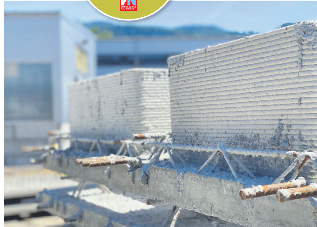
Die Aussparungen für Fenster druckt Concrete 3D mit einem Betondrucker, so müssen sie nicht ausgeschalt werden.
